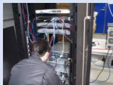
研究科の通信設備の構築
